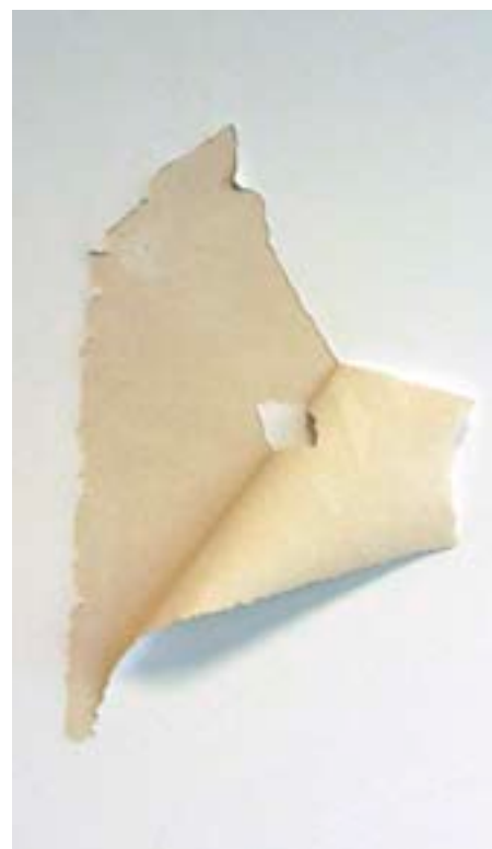
Die fehlende Grundbeschichtung auf Weissputz kann Haftungsstörungen zur Folge haben.
